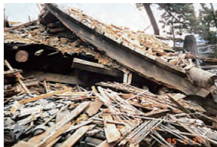
阪神・淡路大震災で完全に倒壊した本堂
