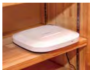
新たに設置されたWi-Fiアクセスポイント装置
